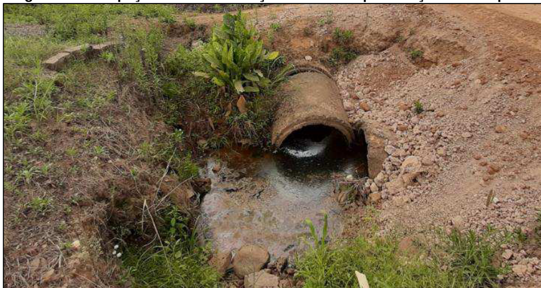
Figura 123 – Empoçamento em tubulação com visível proliferação de mosquitos.
