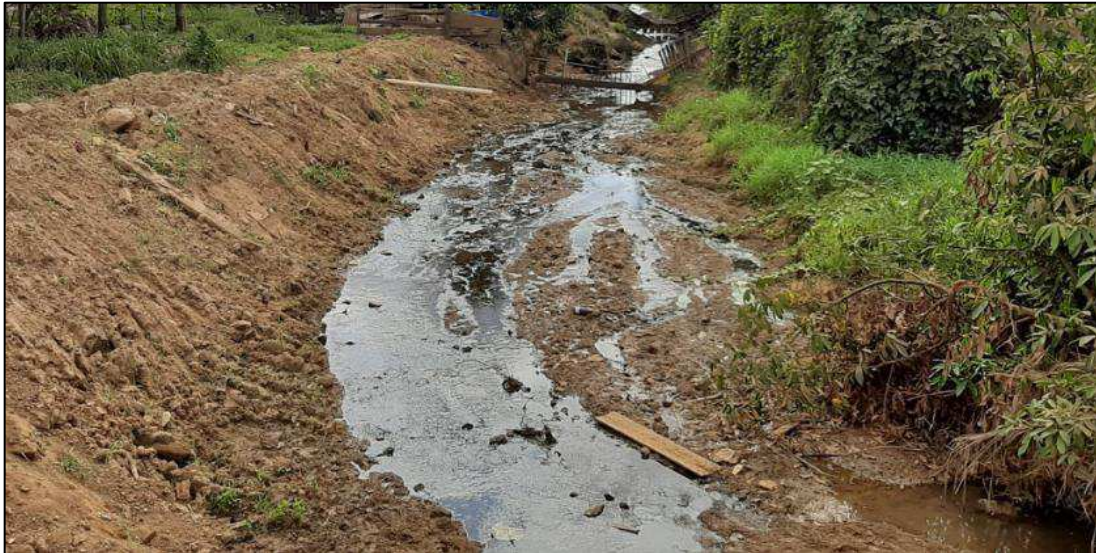
Figura 121 – Canal em Jaru com os taludes descobertos e leito assoreado.
