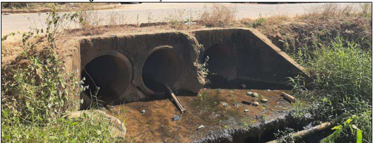
Figura 122 – Tubulações subdimensionadas em Jaru.
